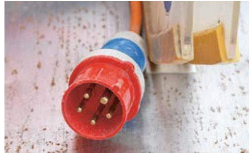
2 Drehstromstecker (CEE) sind rot, rund und 5-polig.
