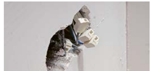
8 Aus der Wand herausragende, isolierte Drähte.
