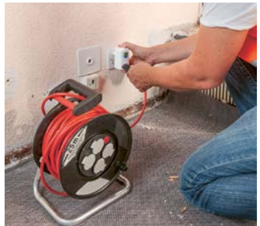
4 Kabelrolle über mobile Fehlerstrom-Schutzeinrichtung (FI-Schutz/RCD) betreiben.
